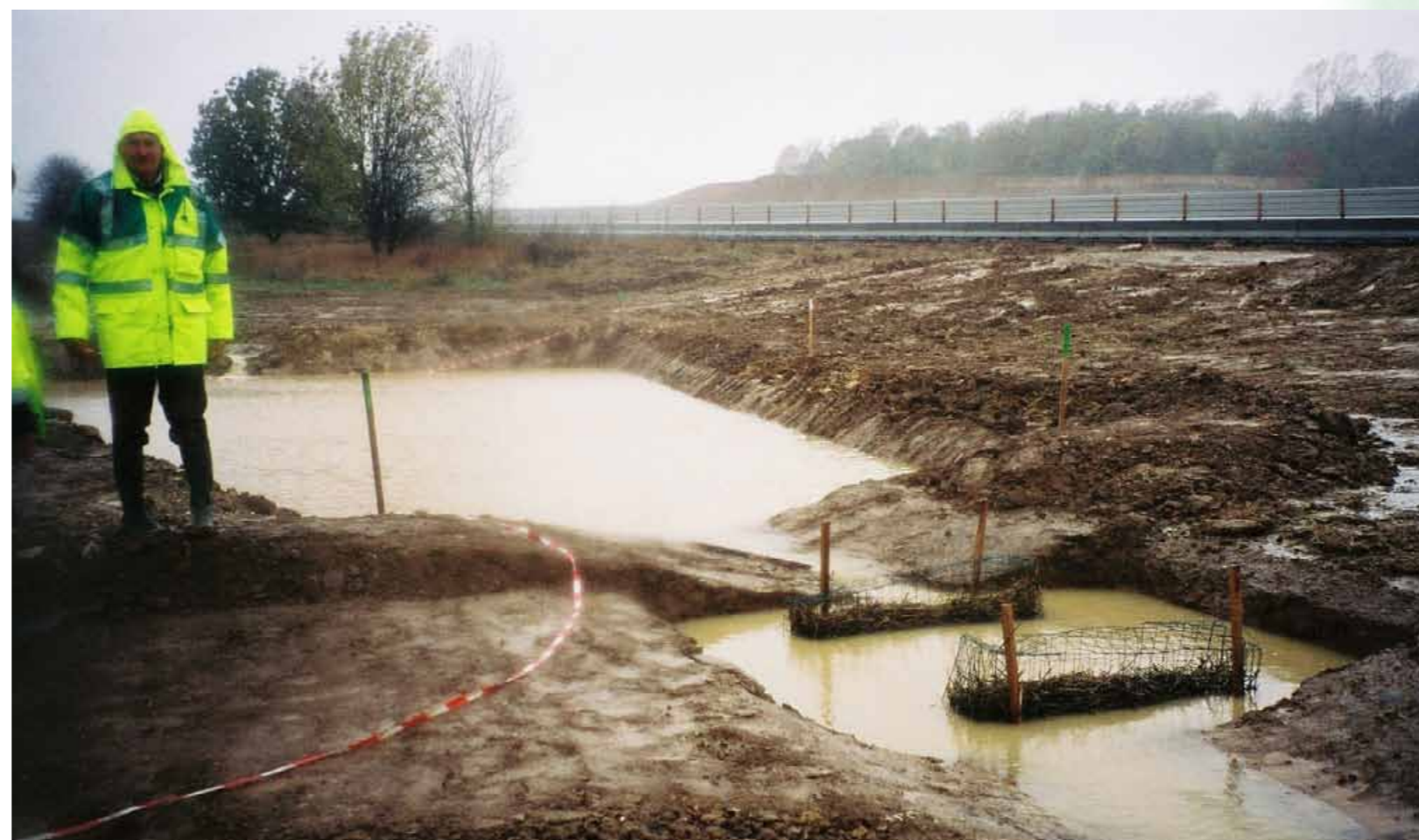
■ Bassin d'assainissement provisoire (source : Equipement et Environnement, 2003)
